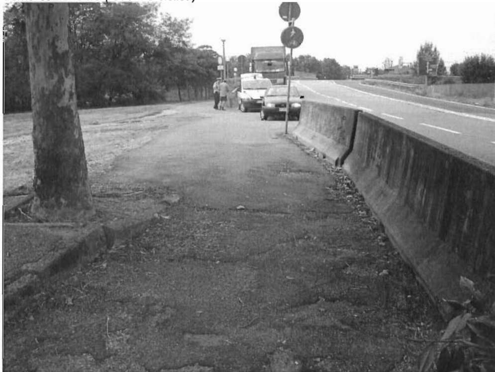
FOTO N. 3: (Via Aselli-Via Marangoni) pavimentazione dissestata e inadeguata, assenza di linea di demarcazione fra pedoni e ciclisti
