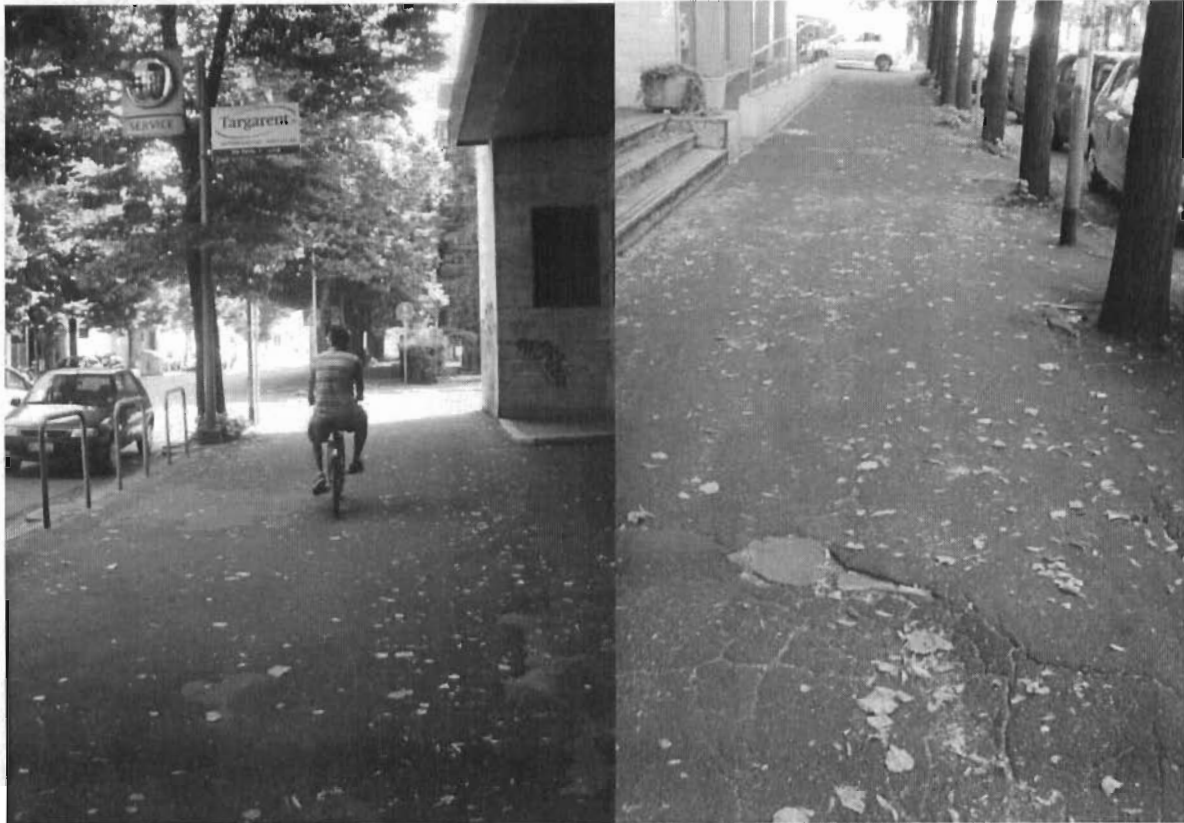
FOTO N. 3 e N. 4: Ciclopedonale V.le Campari: assenza linee demarcatorie pedoni/ciclisti e pavimentazione oltremodo dissestata
