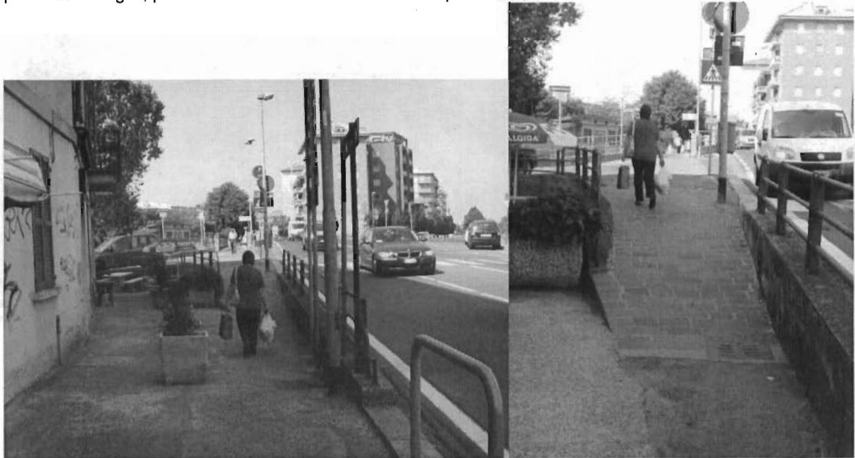
FOTO N. 8 e N. 9: interruzione del tratto ciclopedonale con discesa a piedi verso la strettoia che conduce al ponte del naviglio, pavimentazione dissestata e traffico pedonale.
