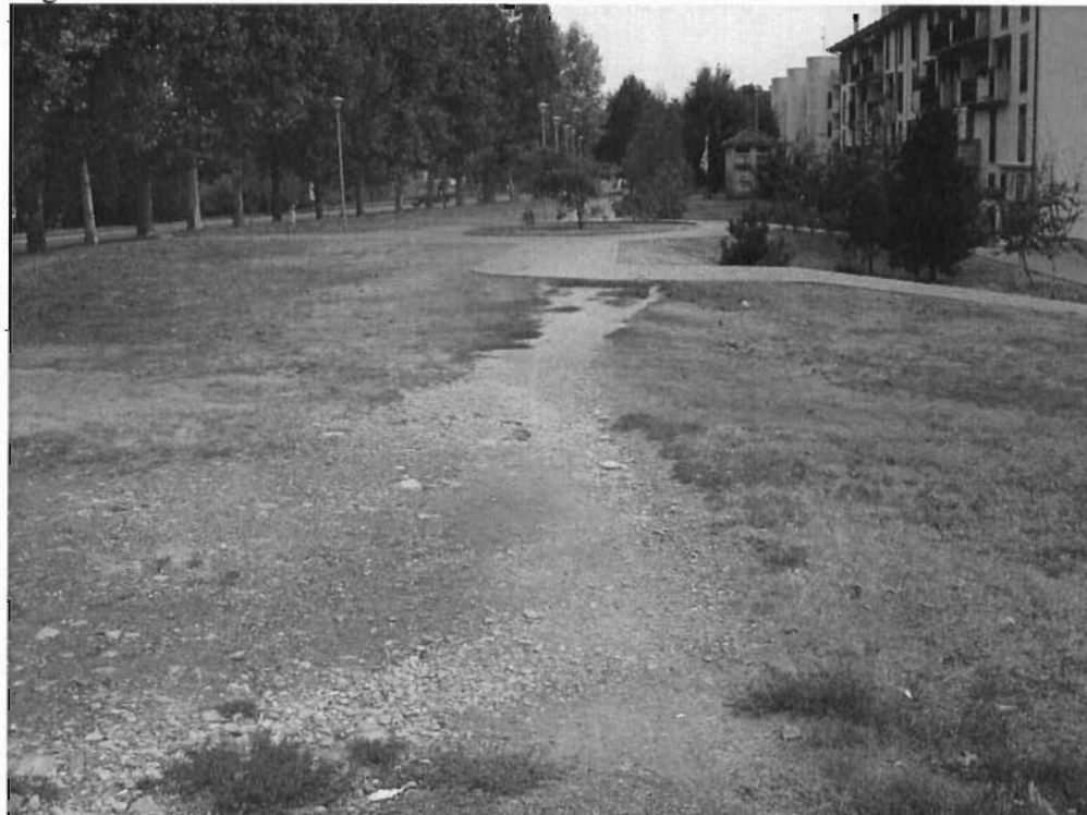
FOTO N. 2: (Via Aselli-Via Marangoni) Pista ciclabile zona via aselli con percorsi senza senso e stato di degrado
